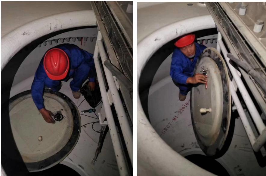
图 3.3 风机传感器安装照片
